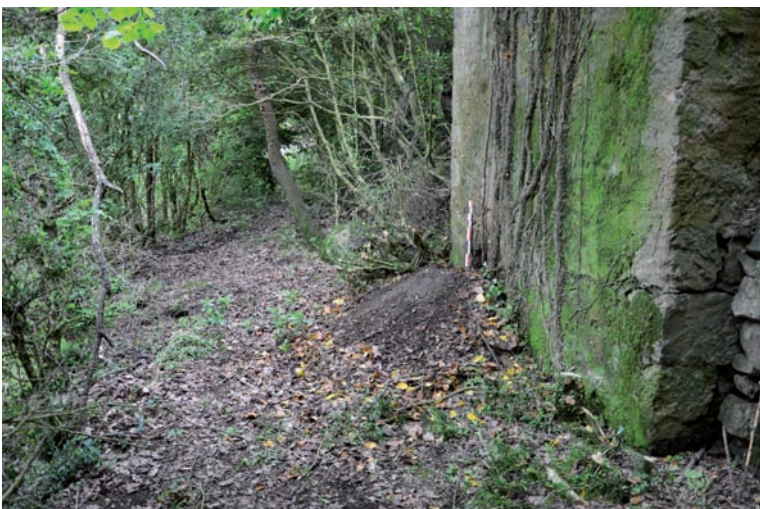
Photo 49. Emplacement de la trappe de visite
